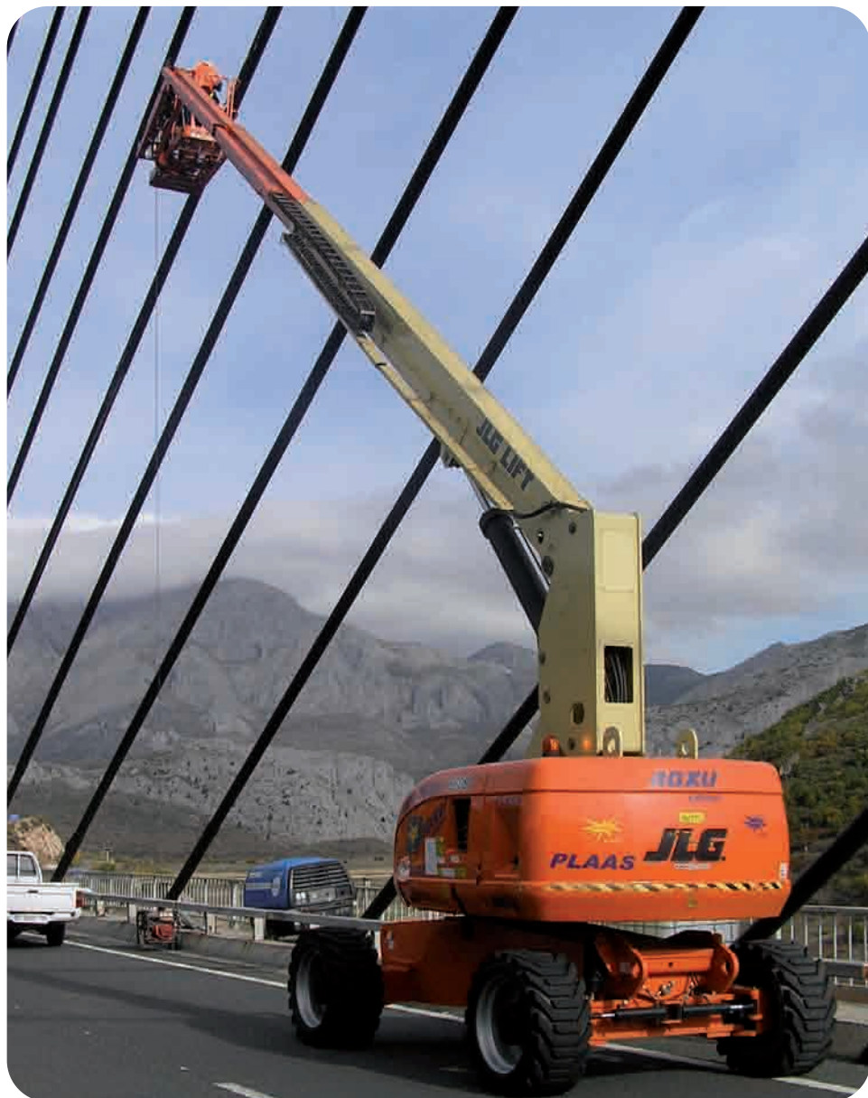
Plataforma modelo 860 SJ realizando trabajos de mantenimiento en el Puente Atirantado AP-66.
